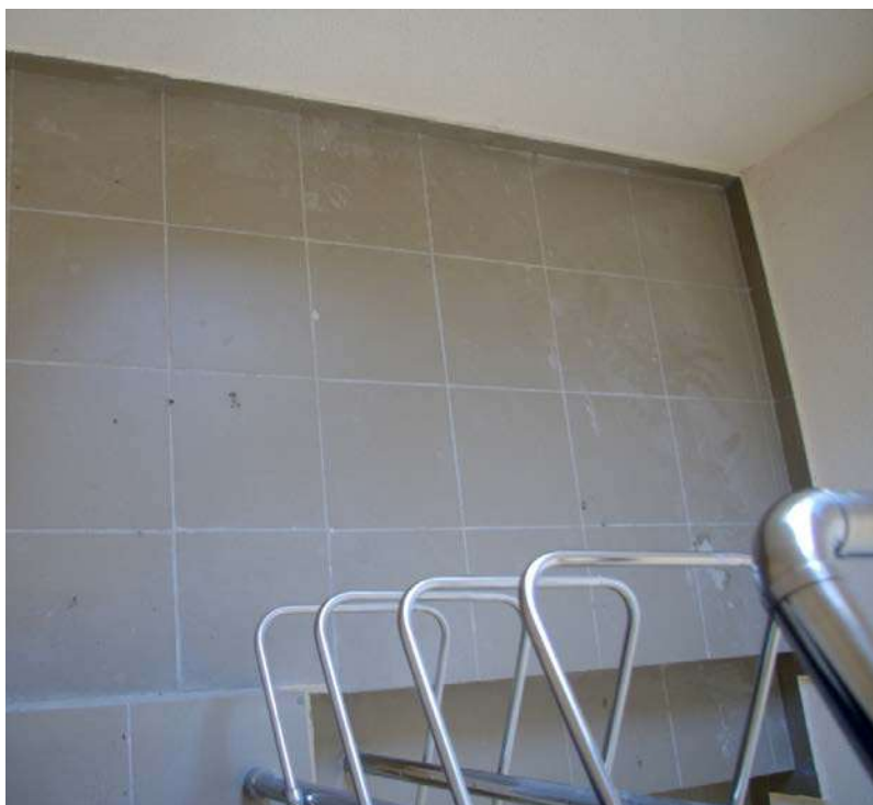
Рисунок 4. Сужение ширины лестничной площадки выступающими конструкциями перил.
