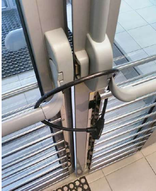
Рисунок 2. Блокирование дверей эвакуационного выхода навесным замком.
